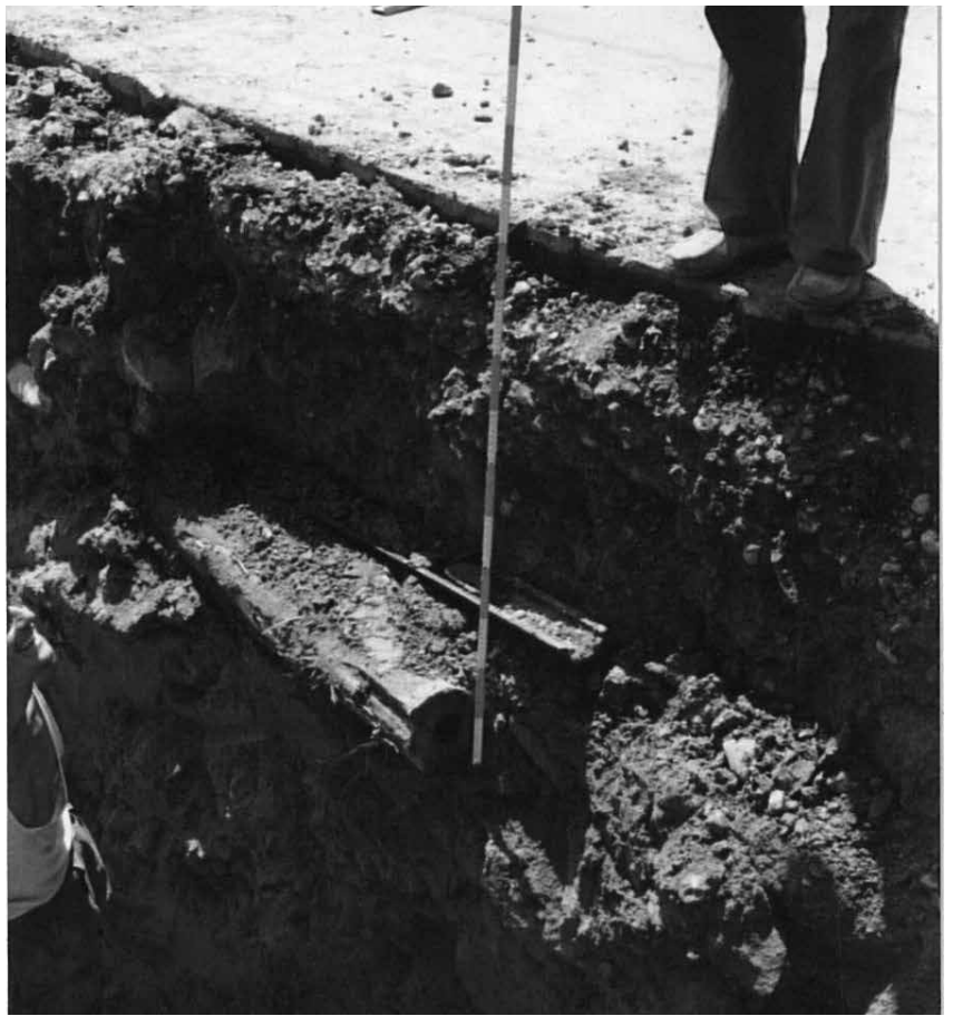
Nach der Abbildung lagen hier an der Teufener Strasse 134 die Teucheln (auch Tüchel genannt) einen Meter unter dem Strassenniveau. Die ausgehöhlten Baumstämme waren einige Meter lang und wurden mit eisernen Muffen miteinander verbunden. Foto Franziska Knoll-Heitz (Kantonsbibliothek VS Q 120/5.2).
